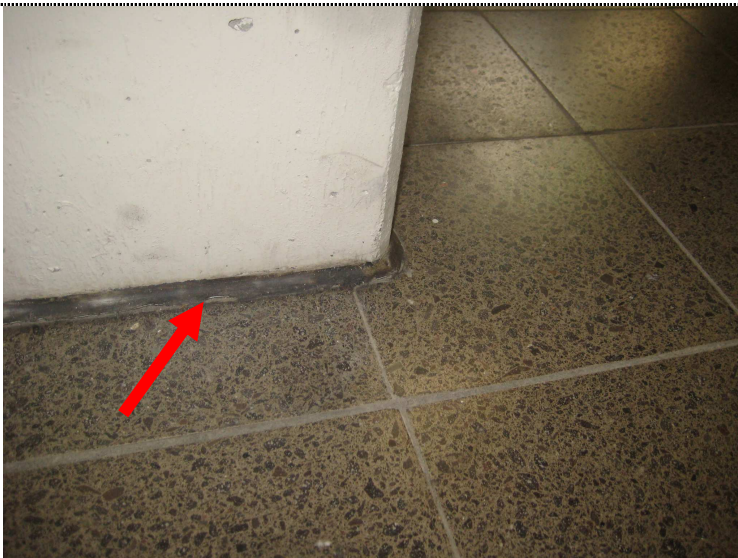
Negativfundstelle: Fugenmasse Stützenanschluss Boden
