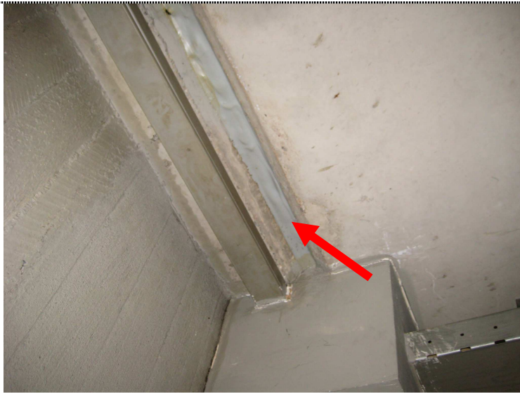
Negativfundstelle: Dehnfuge Decke
