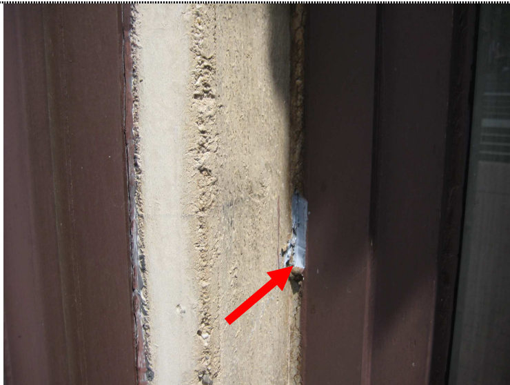
Negativfundstelle: Außenfuge Fenster Beton
